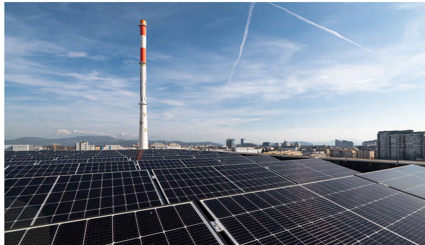
Solarni paneli že proizvajajo zeleno električno energijo na nekaterih naših stavbah v Ljubljani, Murski Soboti, Novi Gorici in Trbovljah. Na fotografiji poslovna stavba na Verovškovi ulici v Ljubljani (foto: Porsche Slovenija).
